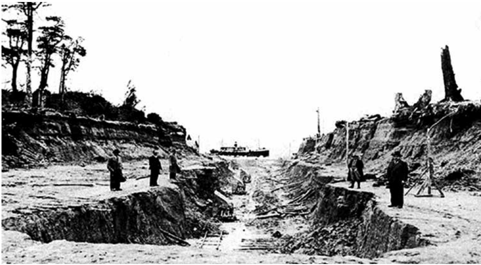
FIG. 05: Boca del canal hacia el norte, muestra el estado de los trabajos hacia 1941. Fuente: Fotografía original de Augusto Grosse Ickler. Recuperado en Martinic, 2013.
