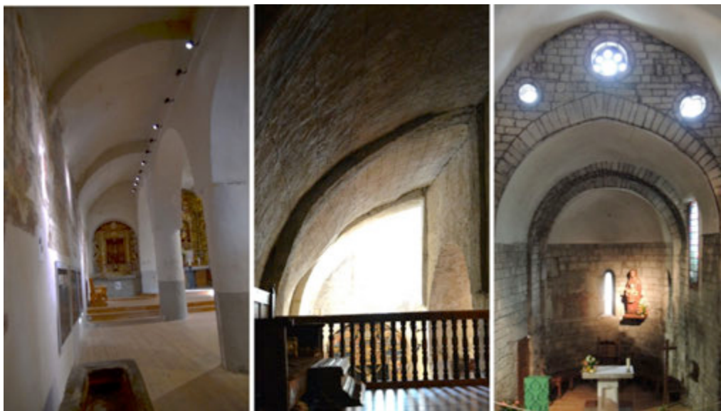
Figure 2. Convex funicular vaults in Santa Eularia d'Unha (12 th c.), Santa Maria d'Arties (12 th -13 th ) and Era Purificació de Bossost (12 th -13 th c.)
